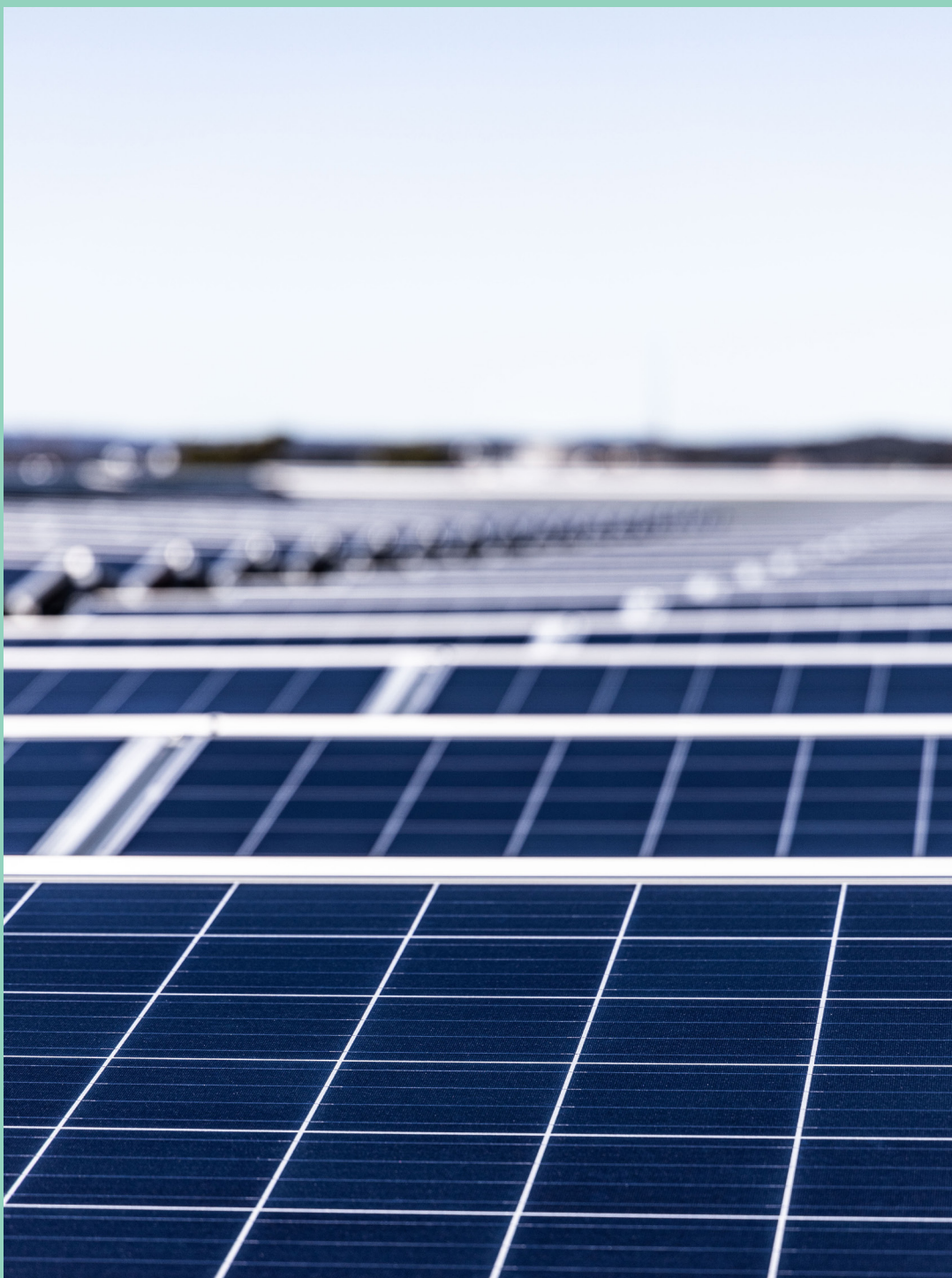
Detaljbilde av solcellene på Stuenes skole. Foto: Mona Hauglid
